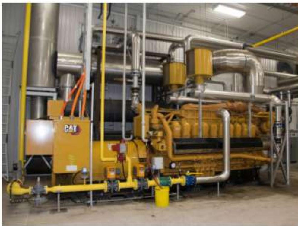
Fig.32 Equipo CHP de cogeneración eléctrica.
